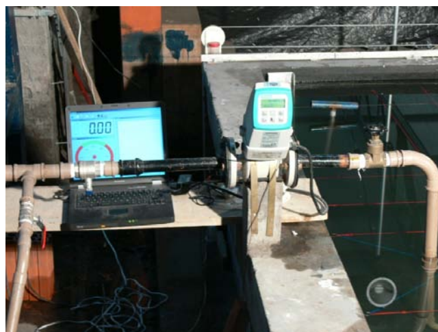
Figura 33 - Medidor de vazões conectado a entrada da tubulação
